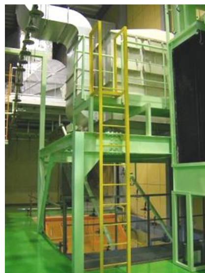
工場内の設置の様子
