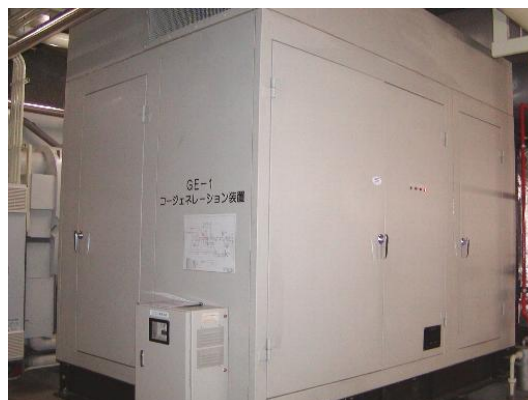
コージェネレーション設備(210kW)
