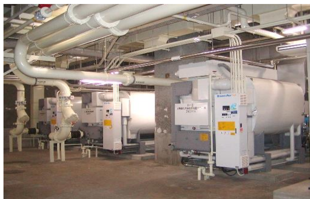
ガス吸収式、排ガス投入型冷温水機
