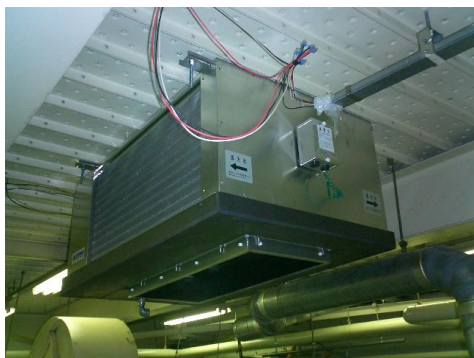
蓄熱空調利用による現行EHPの停止
