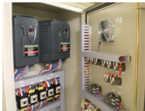
空調用ポンプ差圧制御式インバーター盤
