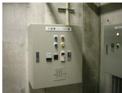
ポンプ・ファンのインバーター制御盤
