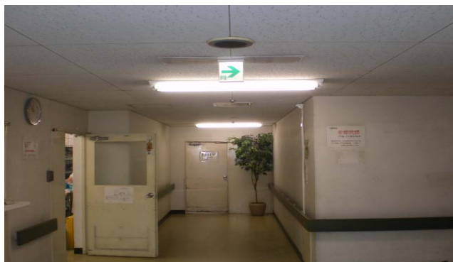
高輝度誘導灯・非常灯
