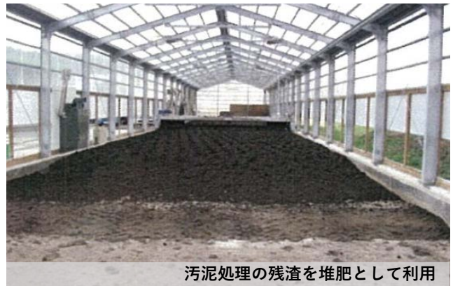
下水汚泥のリサイクル設備
