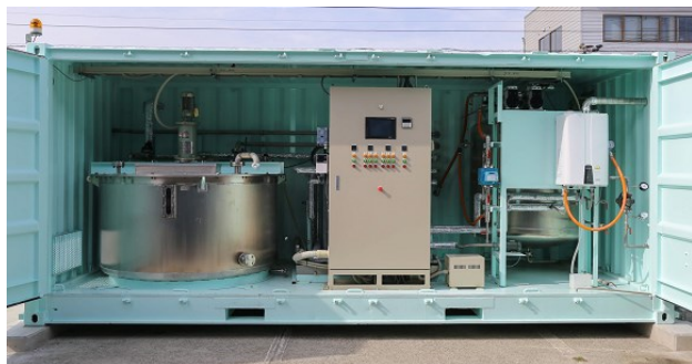
同社が開発した小型プラント 1つのコンテナにプラントが収容されている
