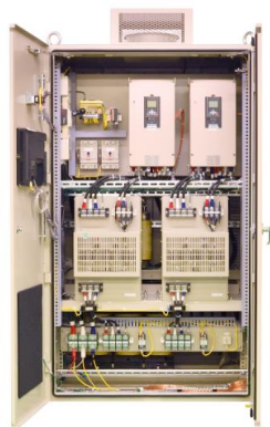
インバータ換気動力盤内部
