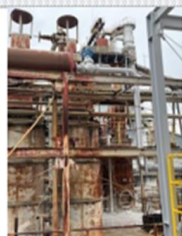
排ガス引き込み
