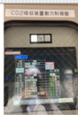
吸収塔制御盤
