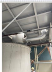
排ガス取り込み
