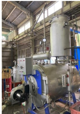
ボイラー燃焼 実証試験
