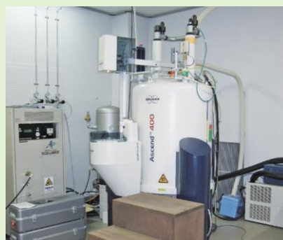
超伝導核磁気共鳴装置（NMR）
