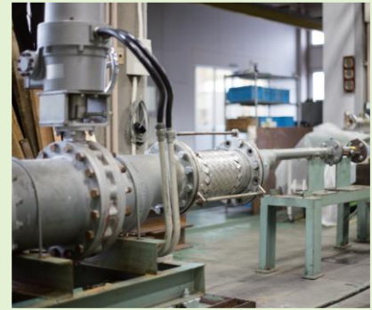
バルブ性能試験装置 (彦根庁舎)
