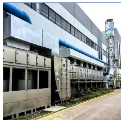
排ガス処理プラント
