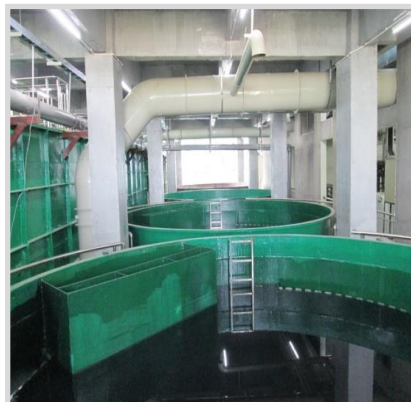
廃水処理プラント
