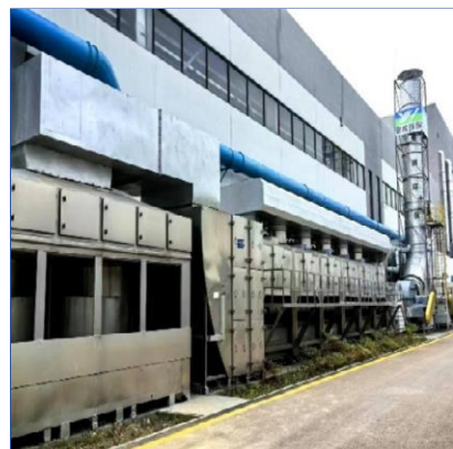
排ガス処理プラント
