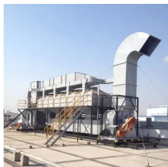
VOCs廃ガス処理工程
