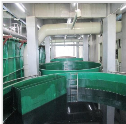
廃水処理プラント
