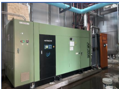
遠心式空気圧縮機排熱回収装置
