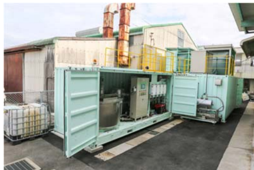
メタン発酵技術を用いた小型バイオガスシステム
