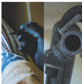
消防設備の設計施工
