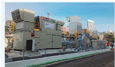
▲水素ガスタービンコージェネレーションシステム (神戸ポートアイランド)
