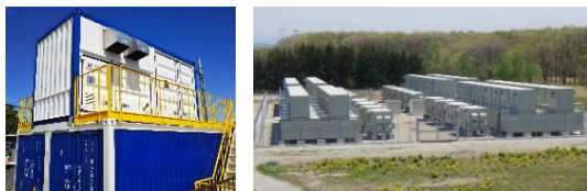
長寿命で安全性が高い蓄電池「レドックスフロー電池」
