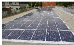
コンパクトソーラー発電所
