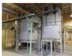
＜Li-ion電池リサイクル設備＞
