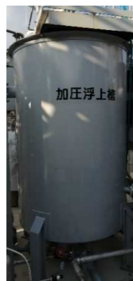
果汁や乳を含む飲料専用の排水処理設備内の加圧浮上装置
