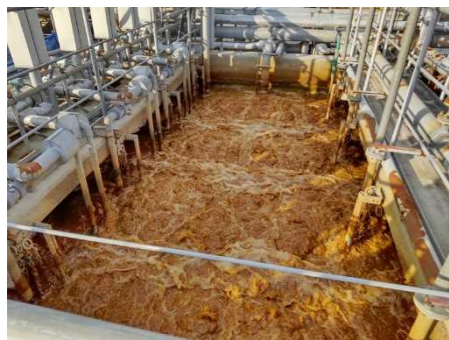
緑茶飲料専用の排水処理設備内における膜分離活性汚泥法のばっ気槽
