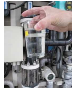
高度処理水設備で処理された排水処理場の水
