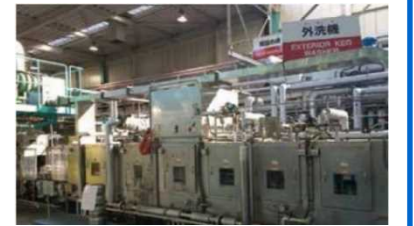
外洗機の水槽を細かく区切り、水のカスケード利用をしながら料飲店向け大樽の外側洗浄を行っている
