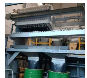
全自動式のフィルタープレス。脱水された汚泥は自動的にドラム缶へ落下する。
