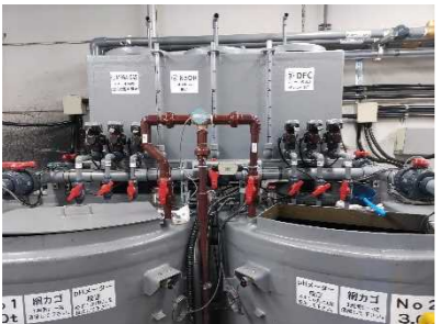
処理槽の上に3種類の薬液タンクが設置されている。
