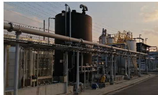
高砂製作所内の高度浄水処理設備
