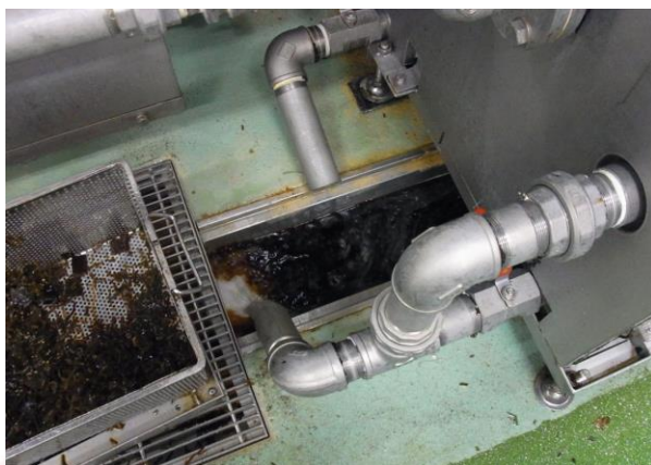
生産設備からの排水
