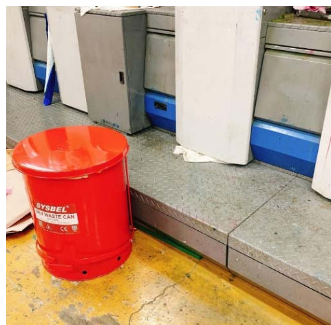
廃ウエスなどを入れる容器として、密閉できる防火ダストボックスを採用している。
