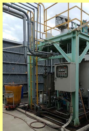
廃捺染糊処理装置の外観
