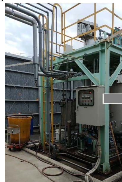
廃捺染糊処理装置。パイプを通じて廃捺染糊が送られてくる。
