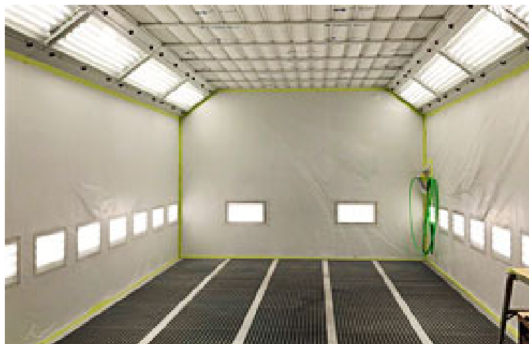
塗装ブースの内部。 塗装の残さが換気設備近くにあるフィルターに付着するため、年 3~4 回フィルターを交換している。
