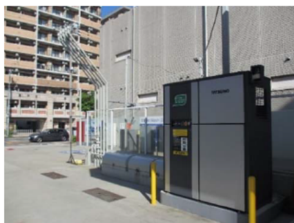
荷卸用ガソリンベーパー回収装置
