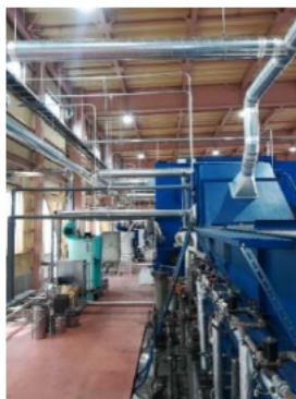
工場内のダクト設置例
