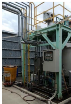
廃捺染糊処理装置。 左右に防音壁を設置し、周辺住宅への騒音防止に努めている。
