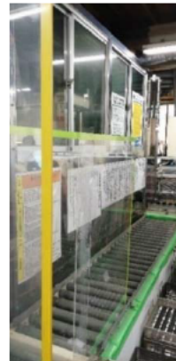
トリクロロエチレンを使用する洗浄設備。 密閉構造のため、VOC は極力排出されない。
