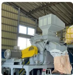
PTP剥離装置（協力会社設置）
