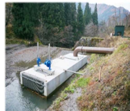
小水力発電施設
