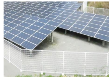
適切に運用される 太陽光発電施設の例
