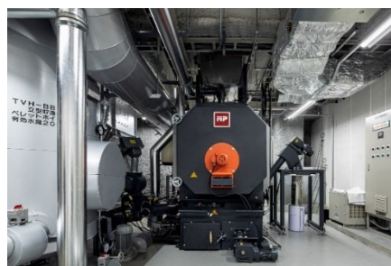
ペレットボイラー
