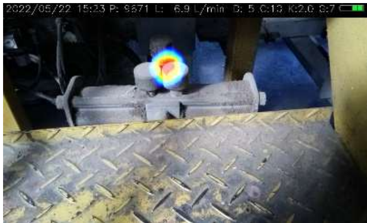
左：エアー漏れ診断画像
