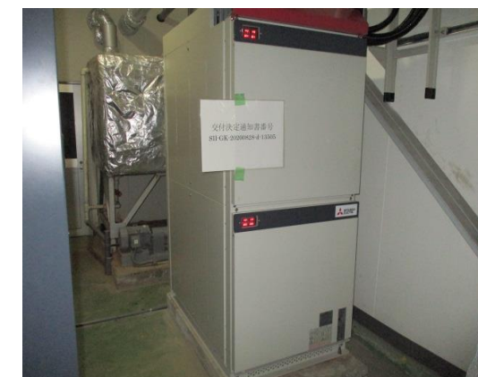
導入した高効率水冷チラー （導入後）
