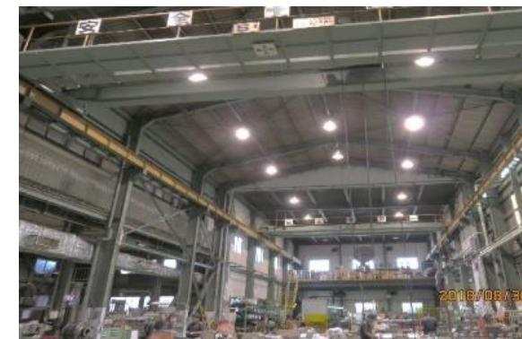
更新後のLED照明
