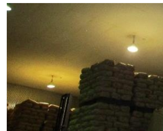
低温倉庫水銀灯（更新前）
