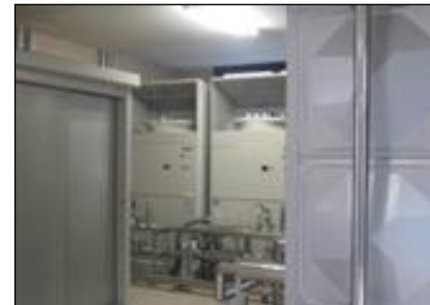
灯油温水ボイラ ⇒ エコキュート
