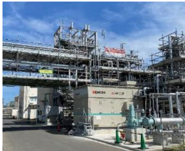
合成ガス製造 (逆シフト反応設備)
