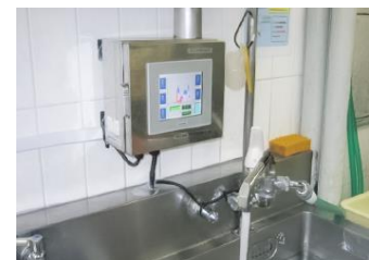
給水制御機器の設置例
