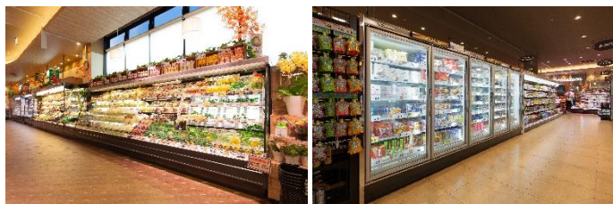
CO2冷媒冷凍冷蔵庫の導入事例
