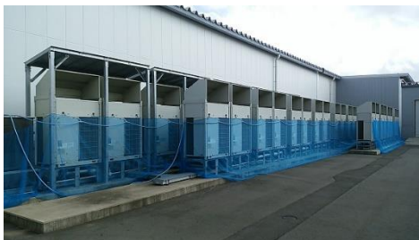
網とホースを室外機に這わせ散水
