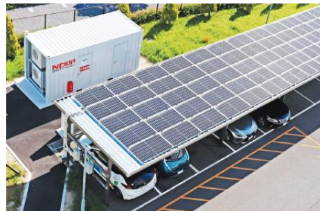
尼崎工場のEVソーラーカーポート
