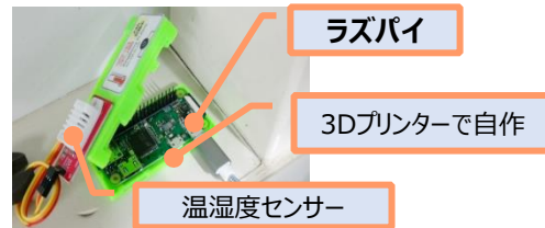
武生工場には12箇所設置
