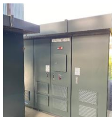
大容量蓄電池で夜間や非常時でも電力の供給が可能に
