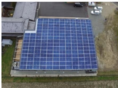
本社オフィスの屋根に自家消費の太陽光発電設備を設置
