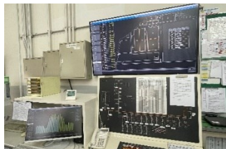
各棟の動力・空調・照明を中心にデマンドを管理
