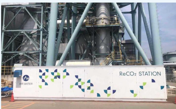
▲CO 2 回収装置 (ReCO2 STATION)
