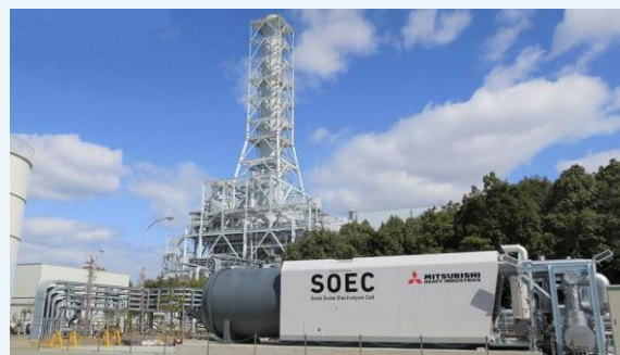
▲高砂水素パークで技術実証中の400kW級SOECデモ機
