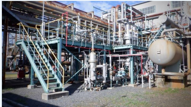
▲水素濃縮システム
