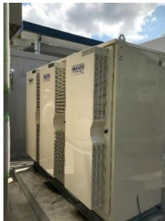
▲燃料電池システム（外観）
