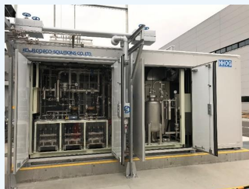
▲水素発生装置 HHOG スキッドマウントタイプタイプ 20Nm 3 /h
