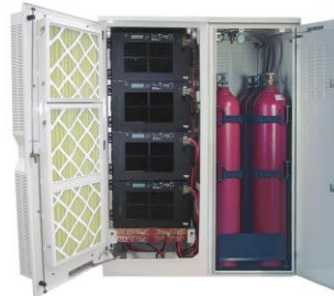
▲10kW燃料電池システム キャビネット内部
