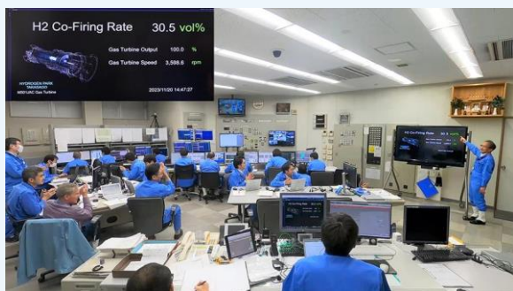
▲水素30%混焼運転実施中の中央制御室
