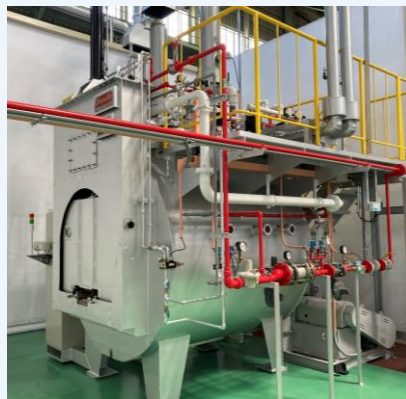
▲ラジアントチューブバーナ式水素燃焼式熱処理実証炉
